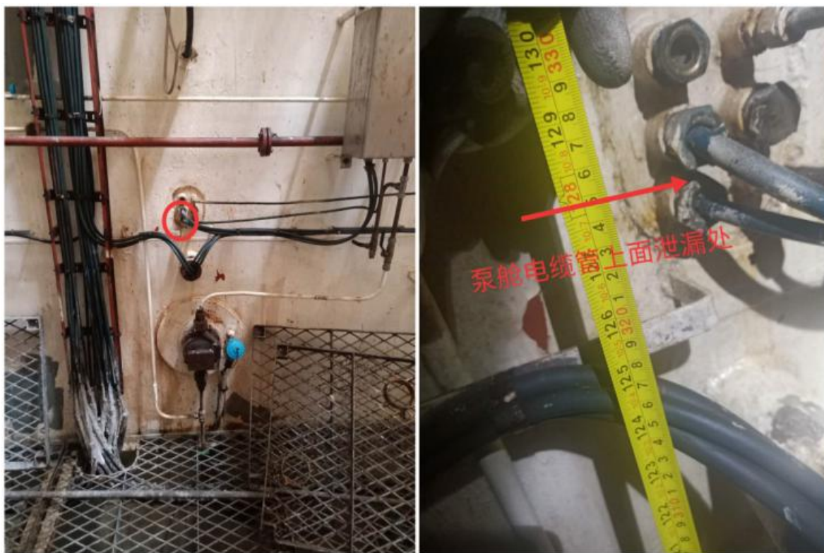
图 6：穿墙管泄漏点位置
