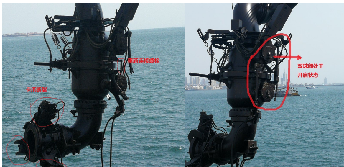
图5：青岛海业油码头船用装卸臂拉断后状况
