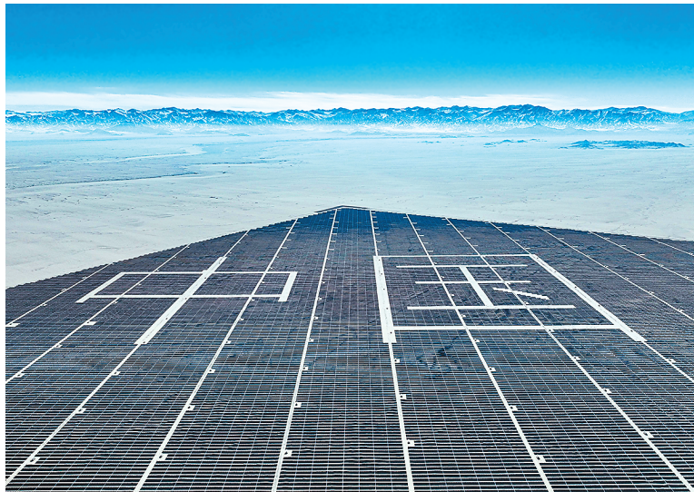
近日，中国石油青海油田格爾木100万千瓦光伏电站并网仪式在格爾木市乌图美仁乡举行，这是中国石油首个百万千瓦新能源集中式并网发电项目。该光伏电站投运后，年均上网电量约19.84亿千瓦时，每年可节约标煤59.83万吨，减少二氧化碳排放179.97万吨，对青海省清洁能源生产基地建设具有重要意义。图为戈壁滩上整齐排列的光伏板。
