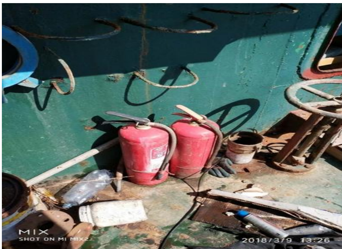
图 3：位于生活区前壁的灭火器处于未使用状态
