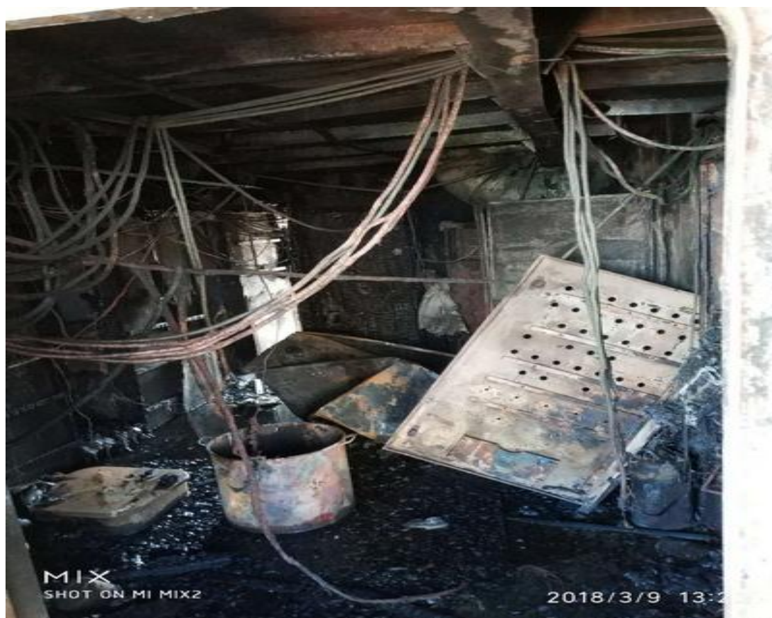
图4：生活区内部过火情况
