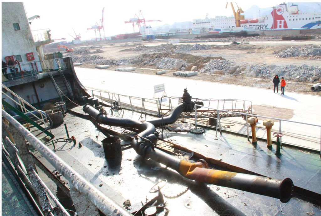
图 5：甲板输油管线断裂移位情况
